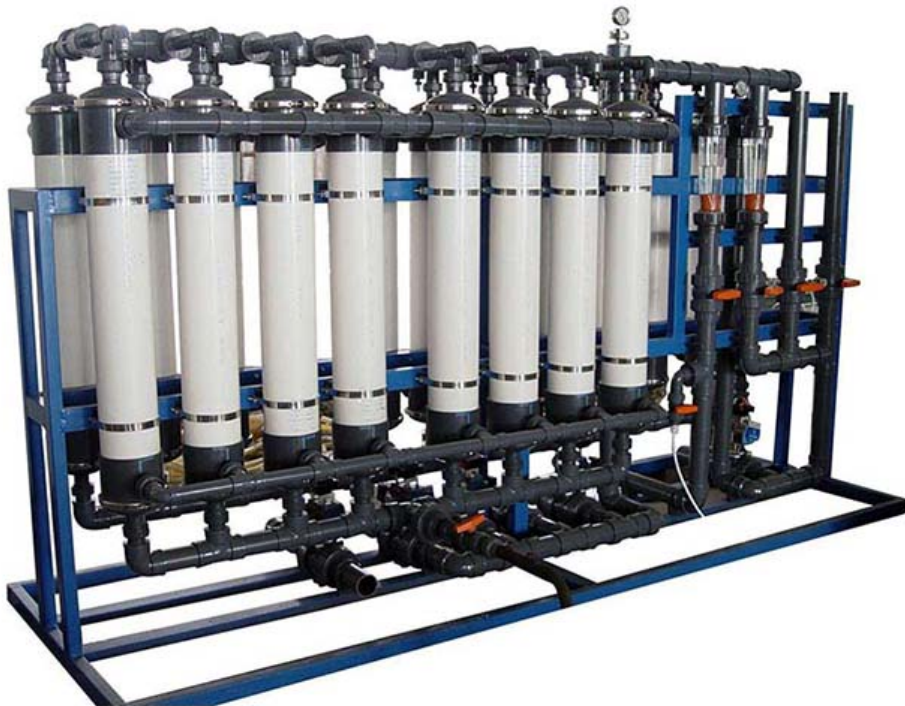
UF Membranes System
